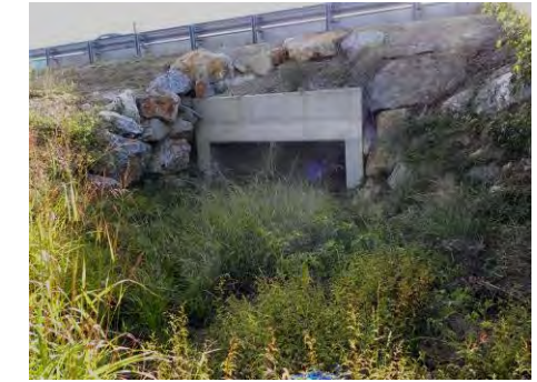
Dalot et exutoire du Pou de les Colobres sous la RD 22c.
